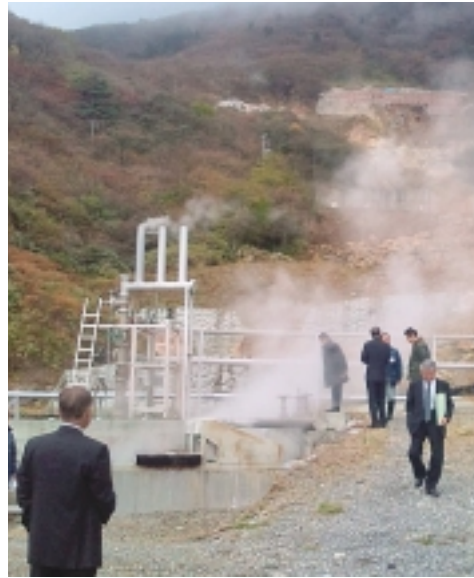
町営の源泉施設（箱根町）
