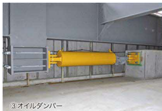
写真 免震装置設置例
