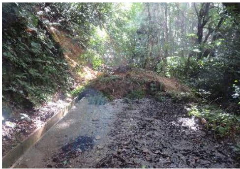
虚空蔵山作業道のがけ崩れ (昨年)
