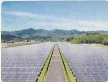
吉野ヶ里メガソーラー発電所
