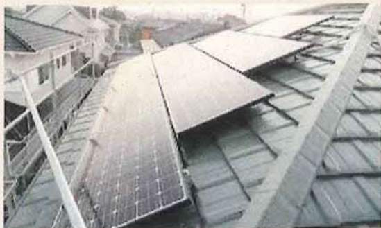
住宅の屋根に設置した太陽光パネル
