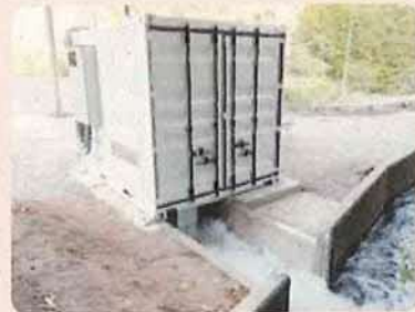
川の水などを利用して水車を回し、電気を作ることができます。 (松隈小水力発電所 (吉野ヶ里町))
