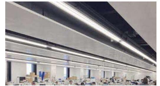
天井放射パネルの事例
