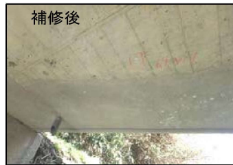
RC床版橋の鉄筋露出
