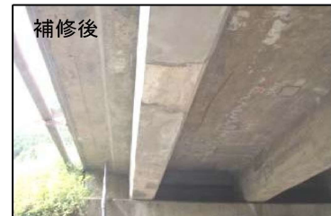
RCT桁のうき
