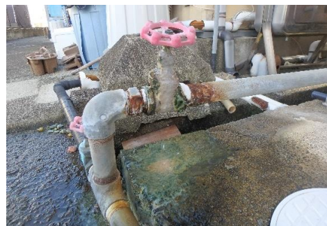
バルブ接続部からの漏湯発生状況
