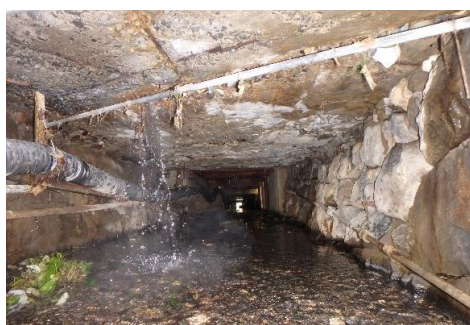
暗渠内枝管からの漏湯発生状況
