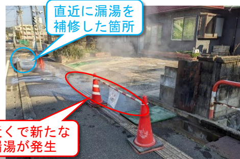
補修実施箇所近くでの漏湯発生状況
