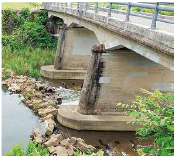
▲ 崩れた護岸ブロック
